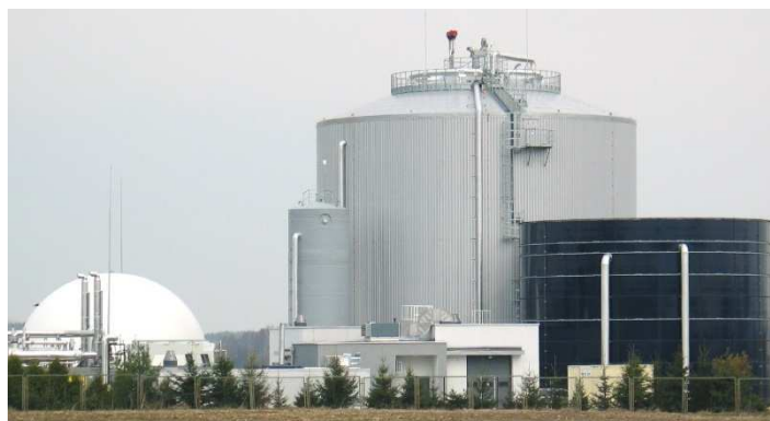
Rys. 2. Reaktor beztlenowy, zbiornik osadu, serwatki i biogazu
